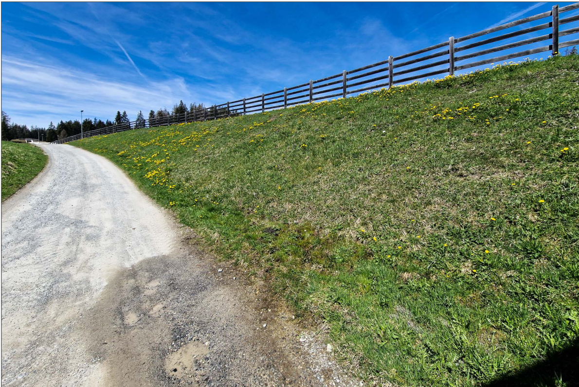
Foto 1: Wasseraustritt aus der südlichen Böschung am 4.5.2023, Grundwasserhochstand. Der Wasseraustritt liegt auf ca. 1386 müM
