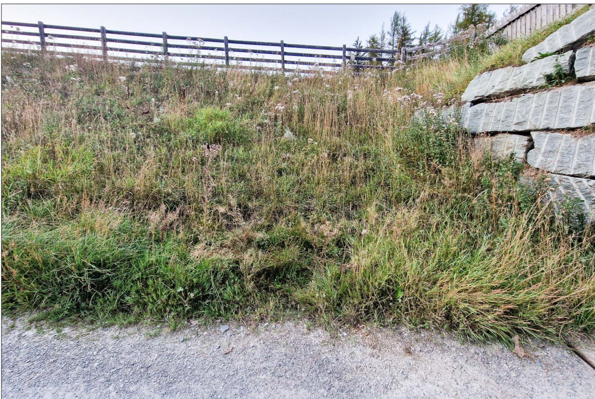
Foto 2: Situation an der südlichen Böschung, bei der Unterführung ganz im Osten am 23.8.2023 (Grundwassertiefstand); es fließt kein Wasser über die Strasse, es gibt lediglich feuchte Stellen in der Wiese (ca. 1385 müM)
